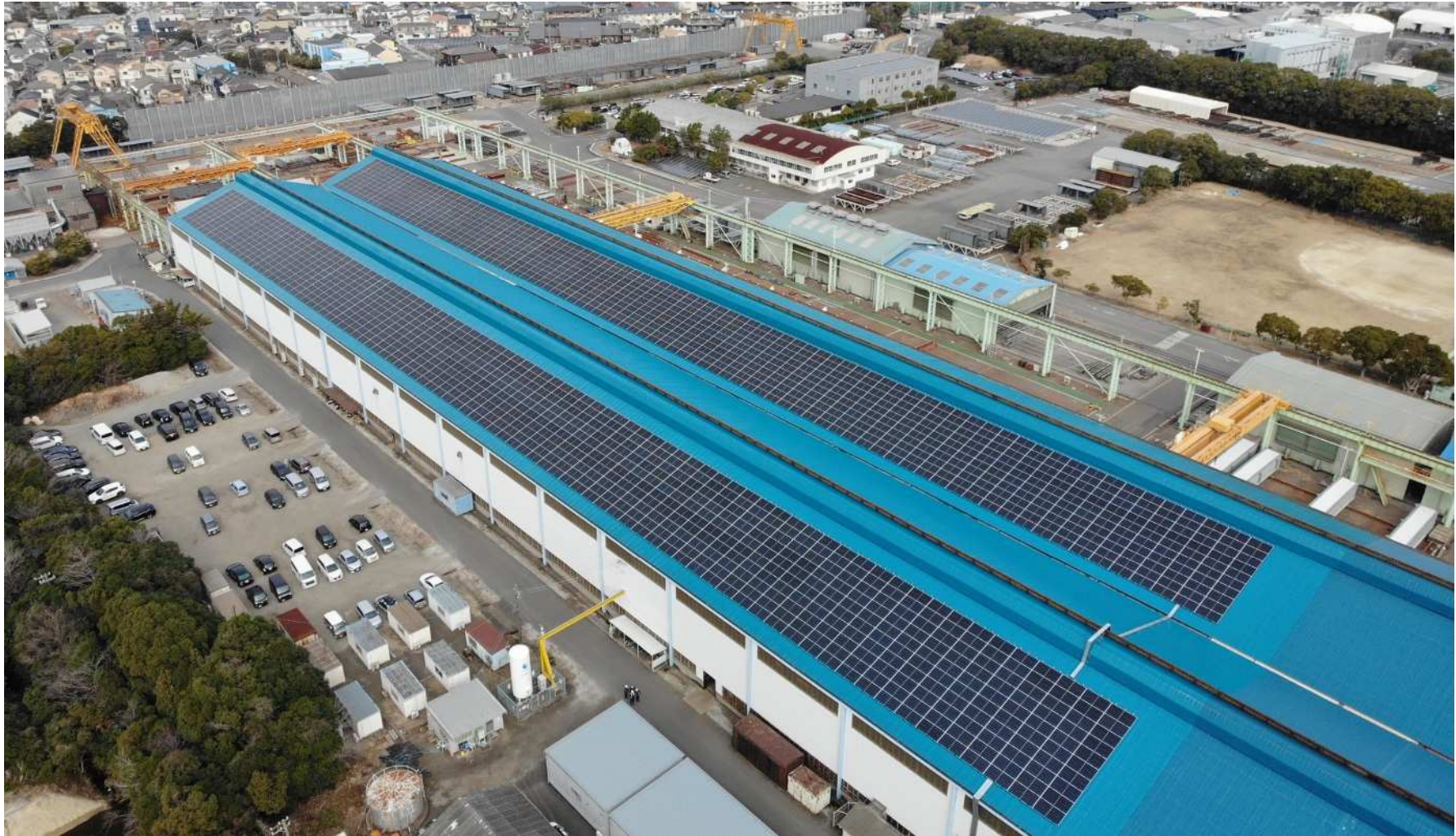
太陽光パネル
