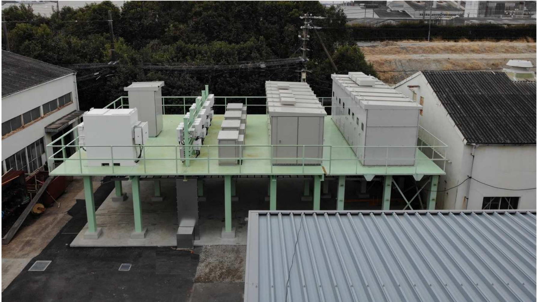
太陽光キュービクル設備
